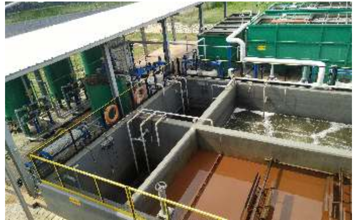
WWTP Pirelli, Subang
